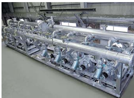
ポンプユニット工場
